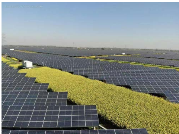
中国节能所属太阳能华中区监利电站
